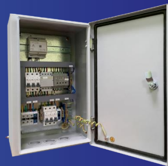
Контроллер БРИЗ-РВ.02 в шкафу управления
